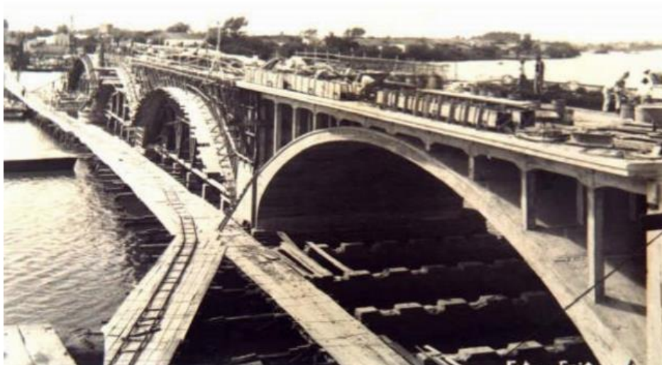
Figura 21 - Construção da Ponte Internacional Barão de Mauá na cidade de Jaguarão RS
